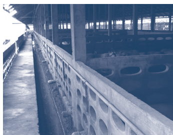
รางระบายน้ำเสีย
